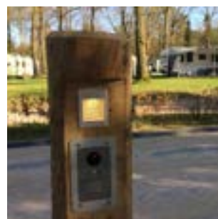
GEGENSPRECHANLAGE MIT BELEUCHTUNG
