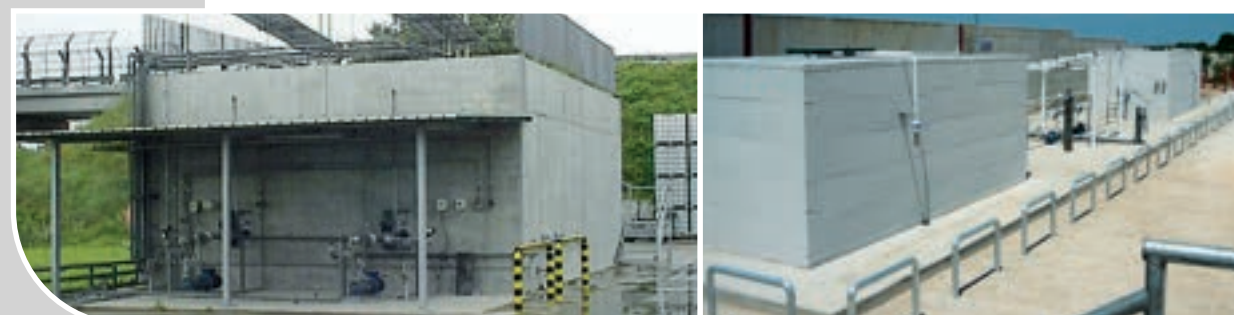
Serbatoio sopra suolo in box di cemento armato per Gas Refrigeranti infiammabili/non infiammabili. StorageTank above-ground in concrete box for Refrigerant Gas (flammable or not flammable).
