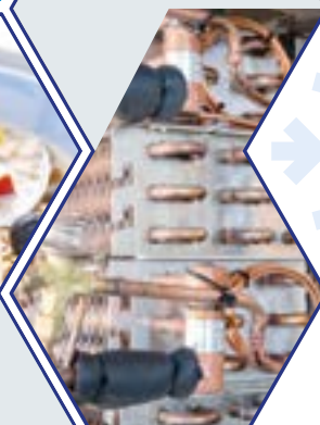
INSTALLATEURE UND INDUSTRIE
