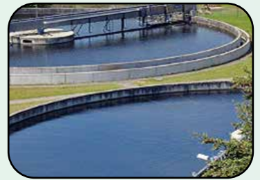
Reinigung und Biogas
