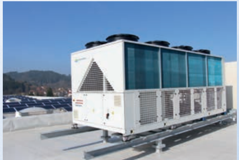
Automobilzulieferer, 410 kW, R410A, Wärmepumpe
