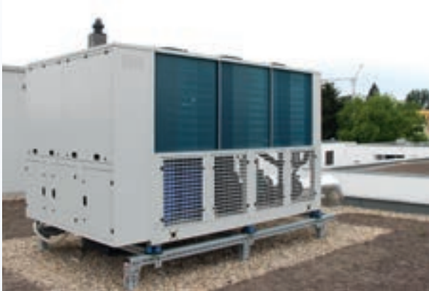
Wohn- und Geschäftshaus, 223 kW, R410A, Wärmepumpe
