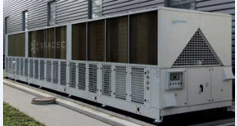
Werkzeugmaschinenhersteller, 939 kW, R134a, mit Freikühlung
