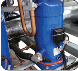
Çoklu Scroll Kompresör Multiple Scroll Compressor
