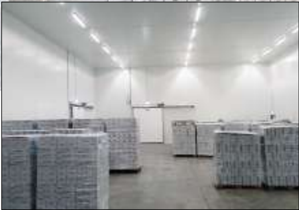
Settore logistico, Cella di conservazione Logistics sector, Storage coldroom Logistik, Konservierungszelle
