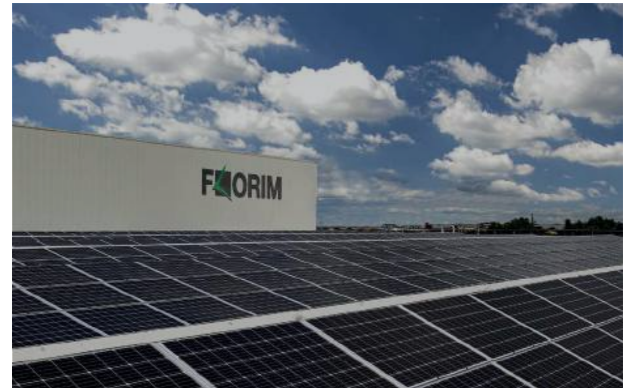
Luftansicht der Photovoltaikmodule des Hauptsitzes (Fiorano Modenese - MO - Italien)
