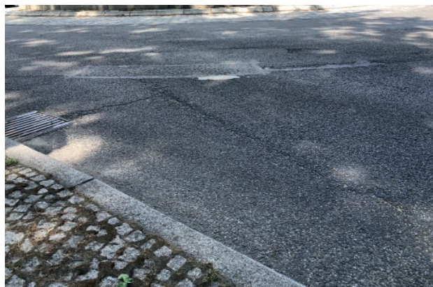
Abb. 1 Kreisverkehrsplatz mit stark geschädigter SMA-Deckschicht
