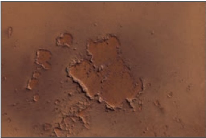
330 Rost tief | rust deep
