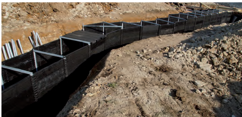
Das System in Ingolstadt
