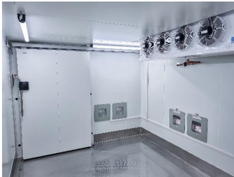
Abbildung 1 Schleuse der ULT-Anlage
