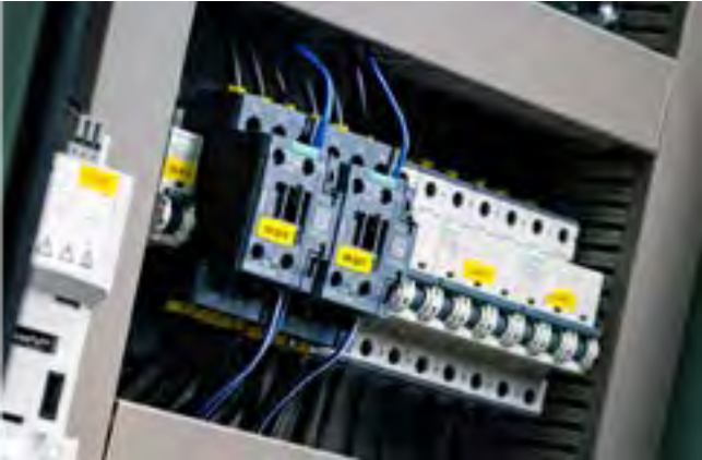
Wartungsfreundlicher Zugang zum Schaltschrank.
