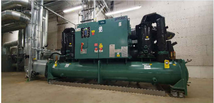
Kompressionskälteanlage in der Kältezentrale des Synus-Gebäudes. Foto: Factor4Solutions
