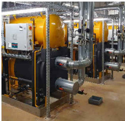
Absorptionskälteanlagen in der Kältezentrale des Synus-Gebäudes. Foto: Factor4Solutions
