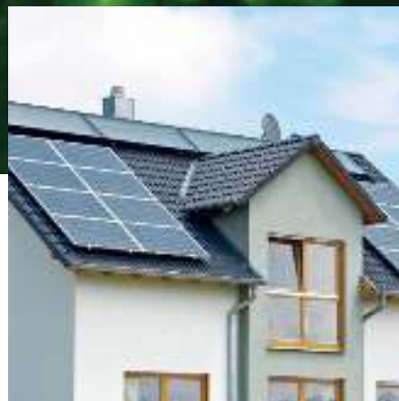
PHOTOVOLTAIK MODULE UND INVERTER
