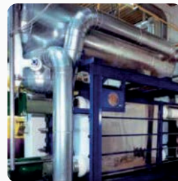
Kältetechnik Heißgas- Wärmetauscher
